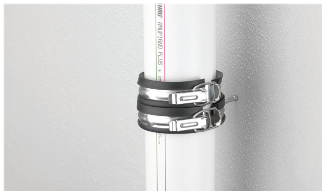
Rys. 6-3 Zainstalowany uchwyt tłumiący
